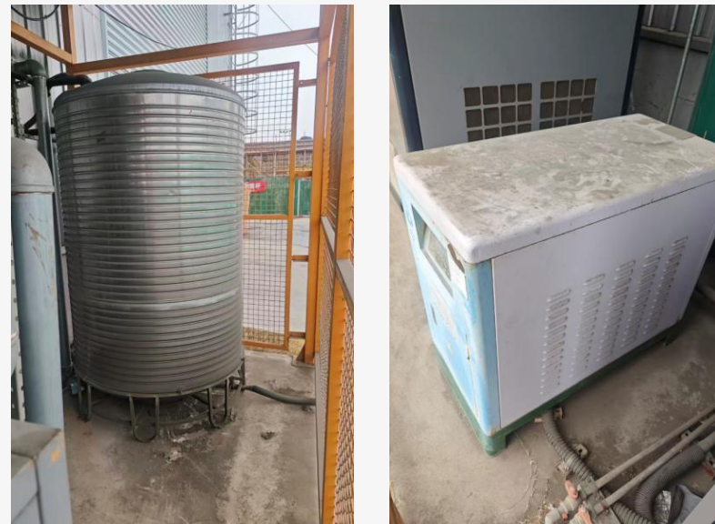
▲ 餘熱回收設備
